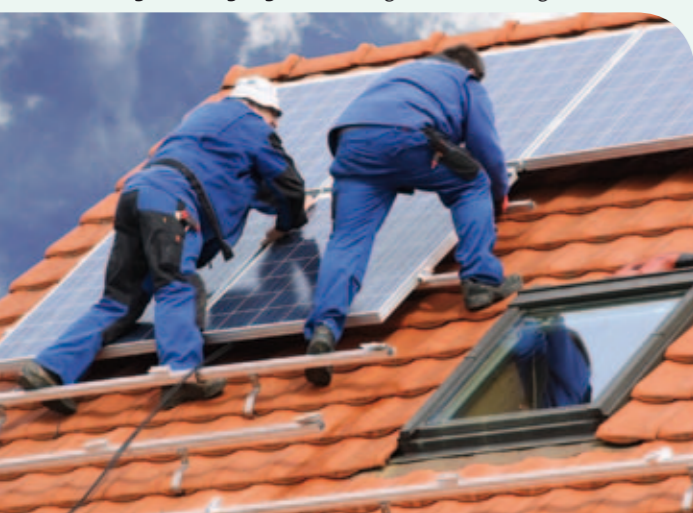
Mängelbeseitigung bei unsachgemäßer Montage
